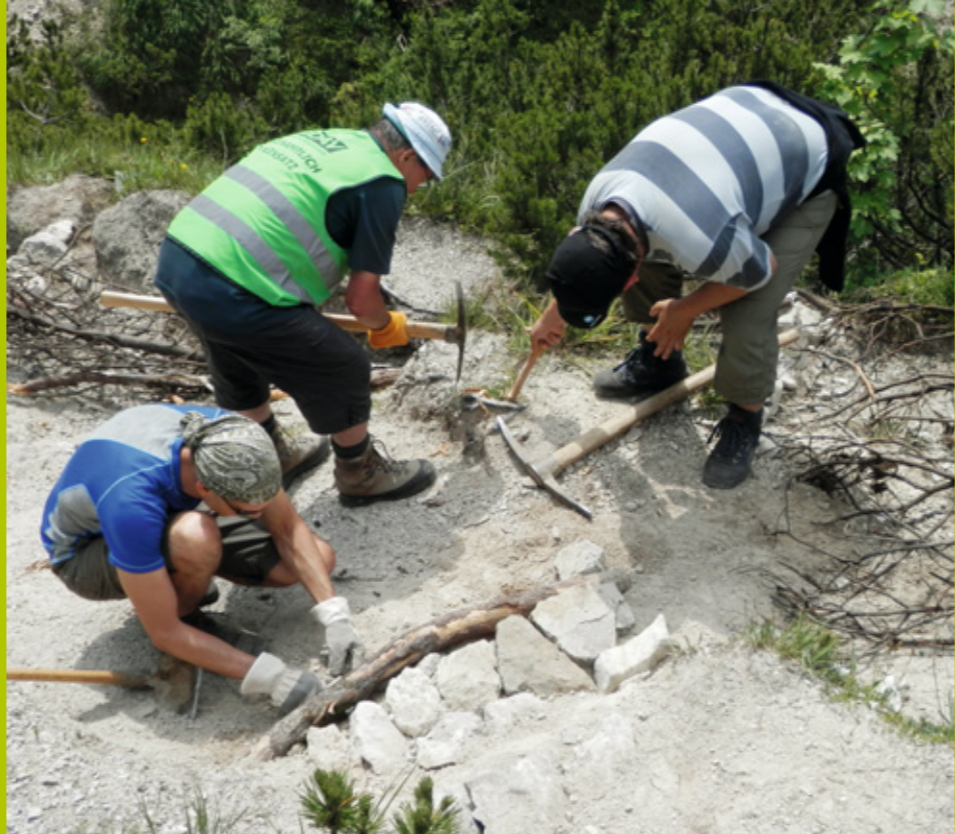
Beschädigte Wege müssen in aufwändiger Arbeit saniert werden, sonst drohen großflächige Hangschäden
